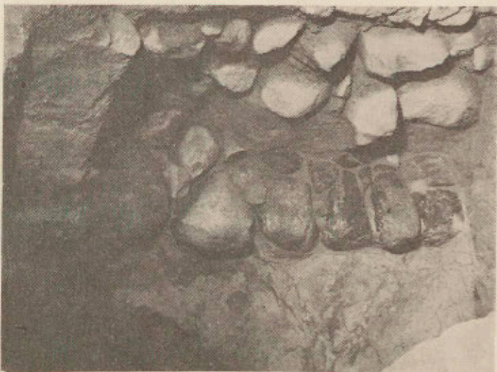
6. Fundament kamienny, zalegający poniżej fundamentu filara pod łuk tęczy, widziany od północy. Fot. S. Kurnatowski.
